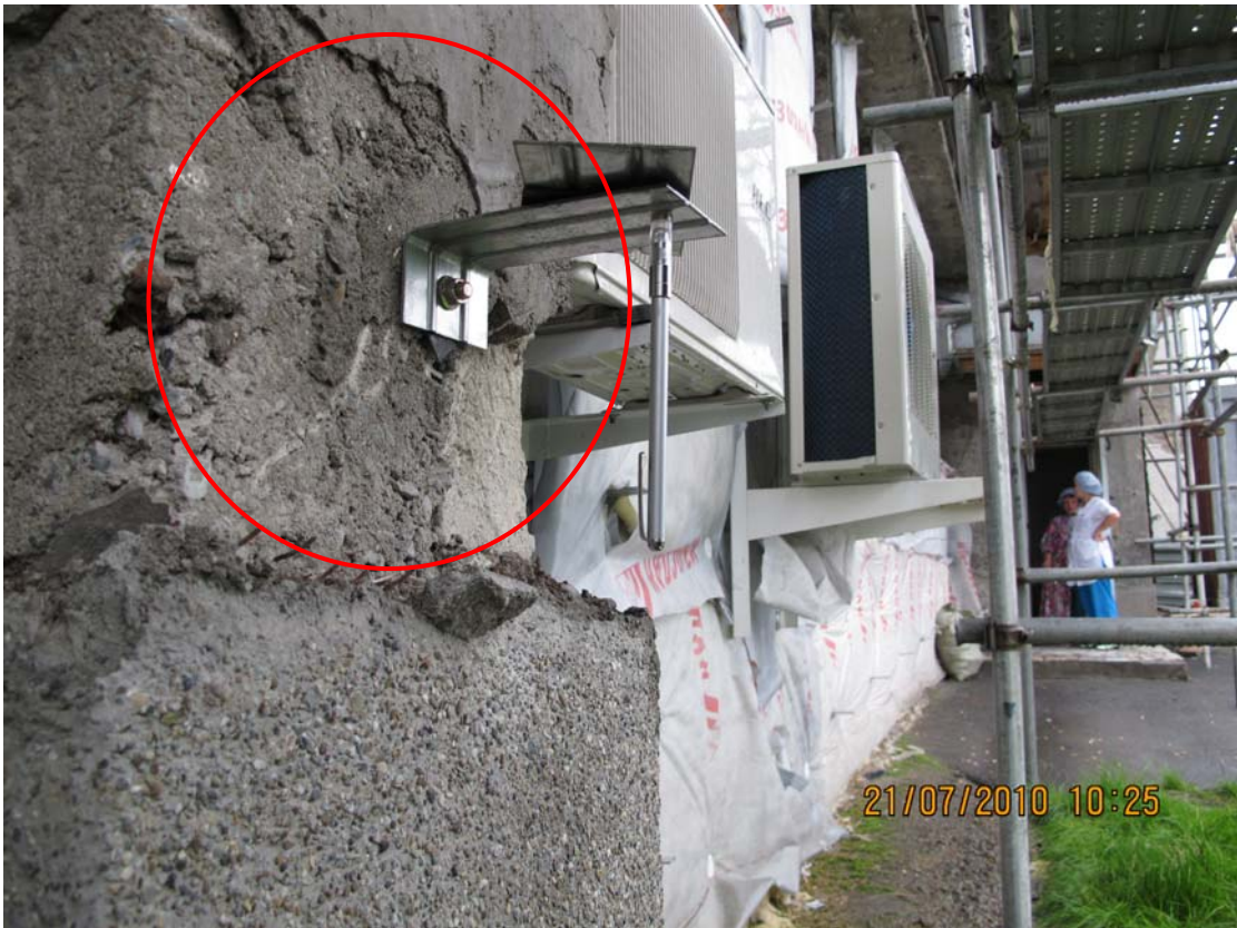
Фото 11. Монтаж несущих кронштейнов выполнен на неподготовленное (поврежденное, с раковинами или наплывами) основание.
