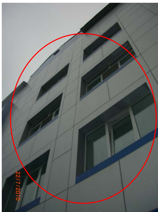
Фото 14. На окнах, в зоне подоконных сливов, не выполнены капельники.
