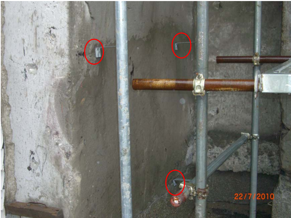
Фото 5. Нарушена схема установки анкера: пластиковая распорная гильза установлена под полку кронштейна.
