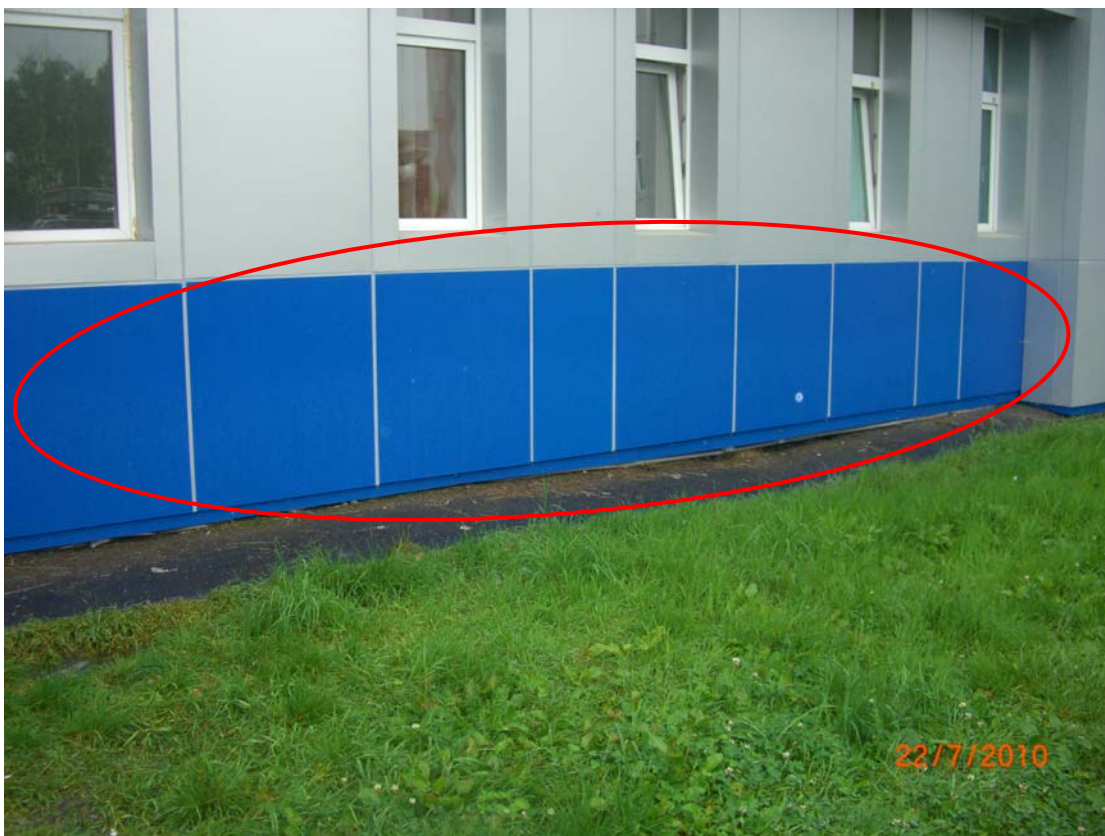
Фото 13. На цоколе смонтирована НФС, отсутствуют мероприятия по защите НФС и утеплителя от воздействия воды, стекающей на отмостку.
