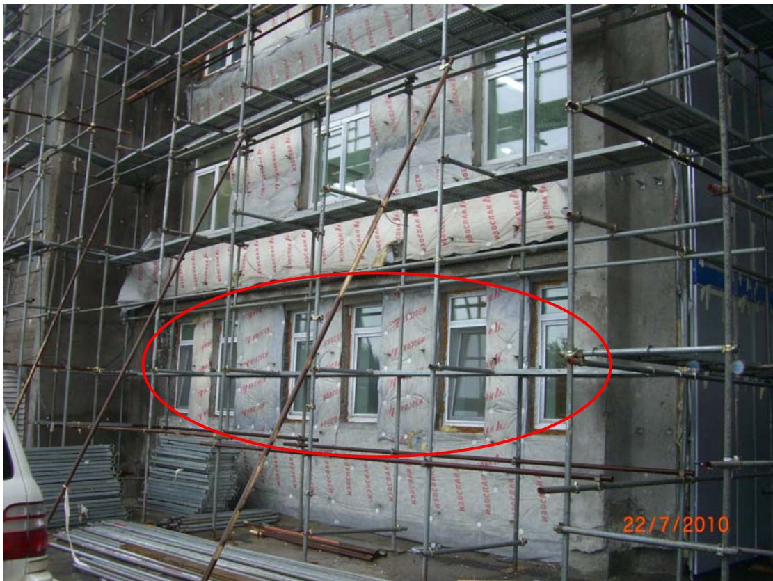
Фото 18. По периметру смонтированных оконных блоков, монтажная полиуретановая пена находится в открытом состоянии.
