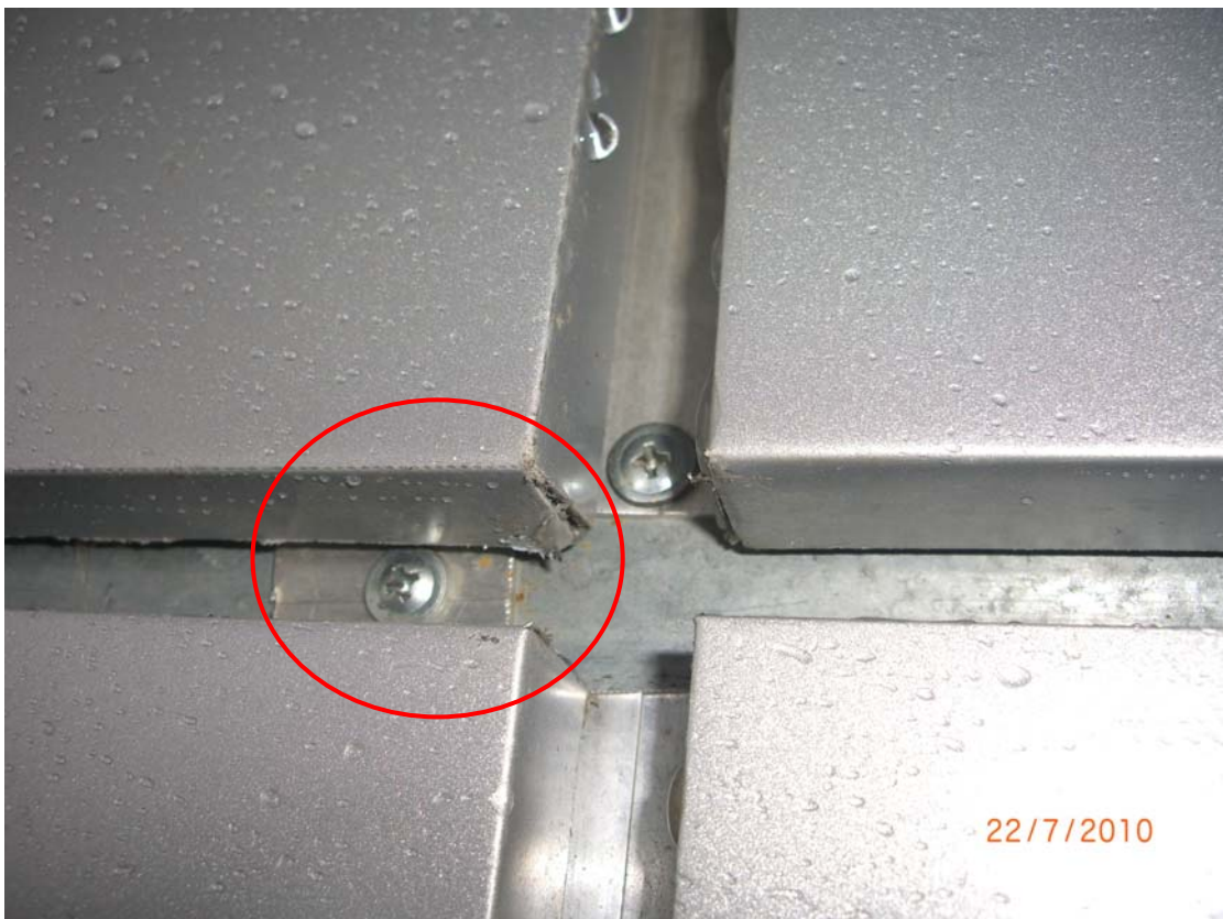
Фото 20. Кассеты из композитного материала смонтированы по «жесткой» схеме: в качестве крепежей использованы алюминиевые уголки, жестко закрепленные к каркасу и кассете.
