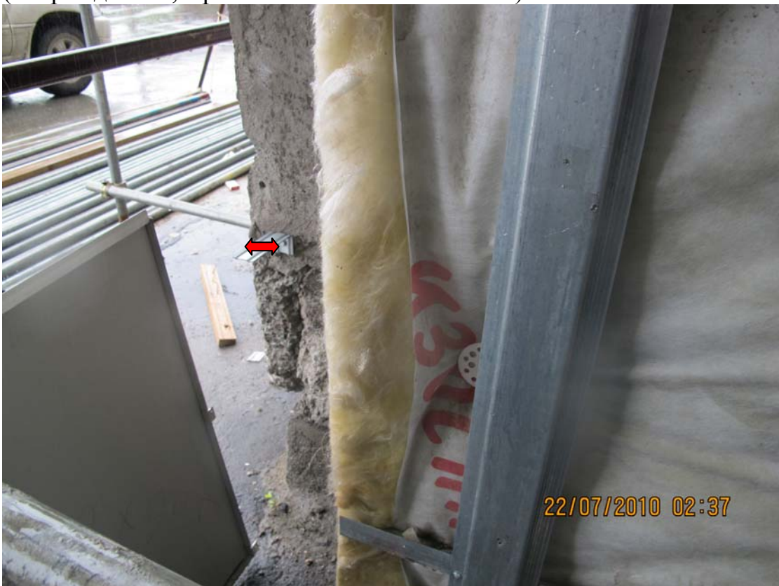
Фото 12. Нарушены требования по минимально допустимому расстоянию от края основания до отверстия – менее 100мм.
