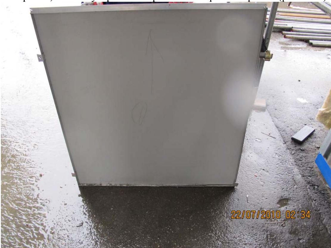
Фото 16. Используемый в качестве облицовки алюмокомпозитный материал не соответствует представленному ТС.
