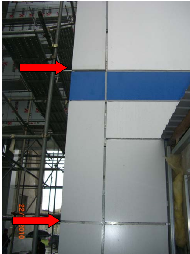
Фото 19. Каркас НФС смонтирован без учета разрезки на термокарты.
