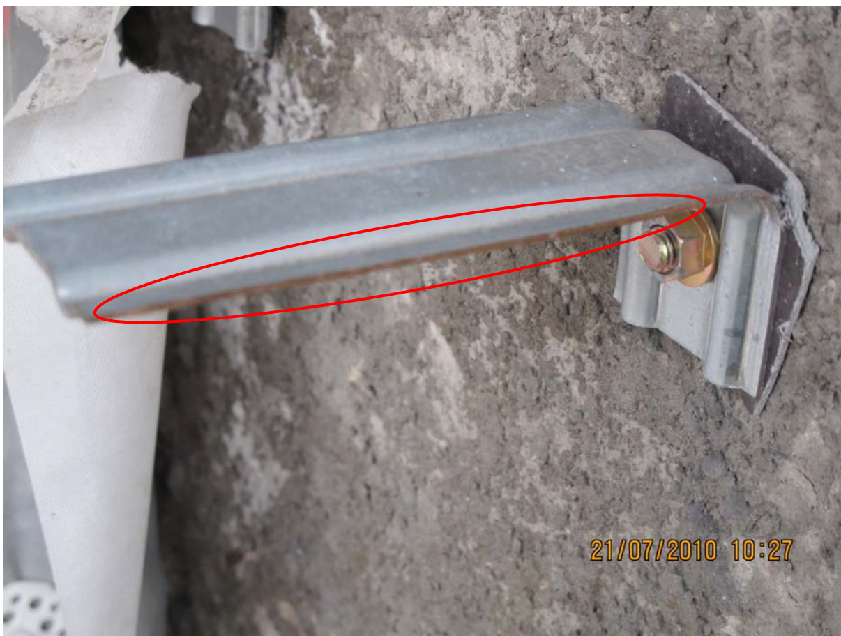
Фото 3. Следы коррозии на установленном кронштейне.
