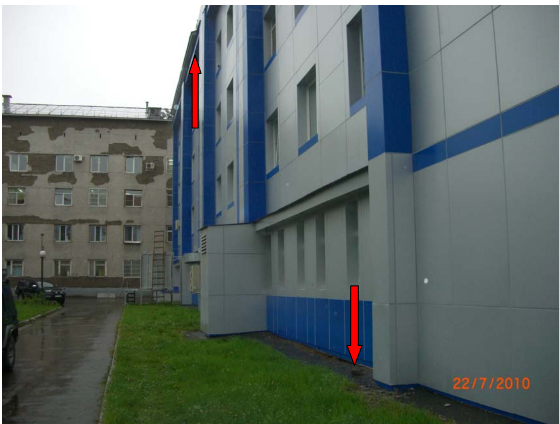
Фото 9. По нижней и верхней границе смонтированной системы отсутствуют продухи для вентиляции подблицовочного пространства.
